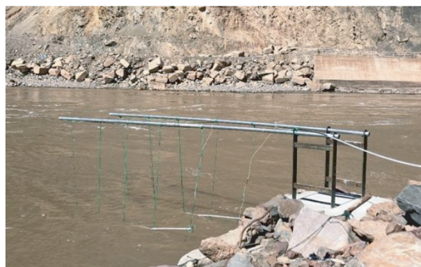
图5 果多水电站集运鱼系统电驱鱼设施实拍图
